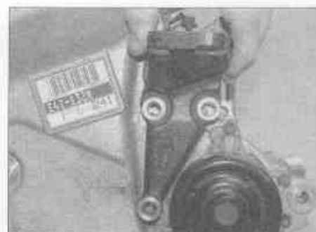
Рис. 5.10. Выверните болты/отверните гайки и снимите кронштейн правой опоры двигателя с блока цилиндров
