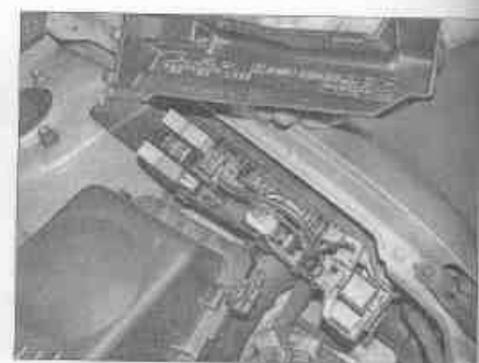
Рис. 4.3,б. Реле вентилятора в главной коробке плавких предохранителей (бензиновые модели)
