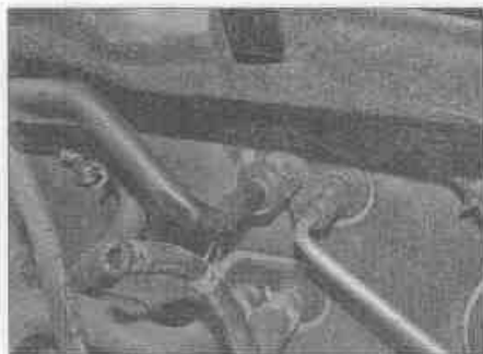
Рис. 12.8. Трубопроводы кондиционера, проходящие через перегородку
